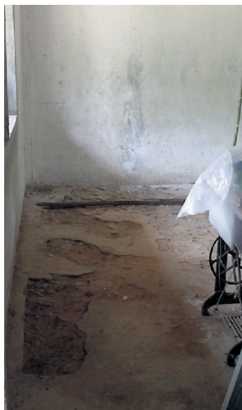
STOR SLITASJE: Slik ser det ut på gulvene inne i klasserommene.
