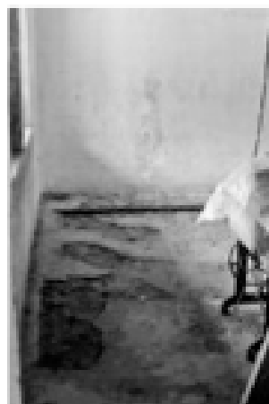
DÅRLIG STANDARD: Gulvet inne på et av klasserommene.
